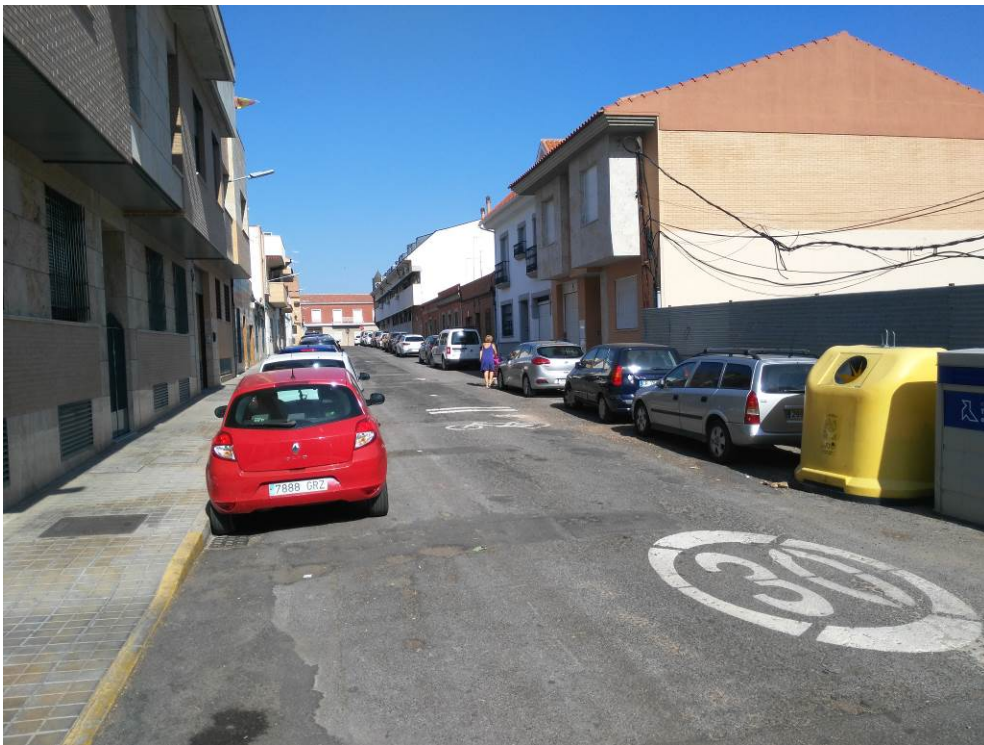
Estado general del pavimento de calle Azuer, donde se observan diversos baches y reposiciones de asfaltado.
