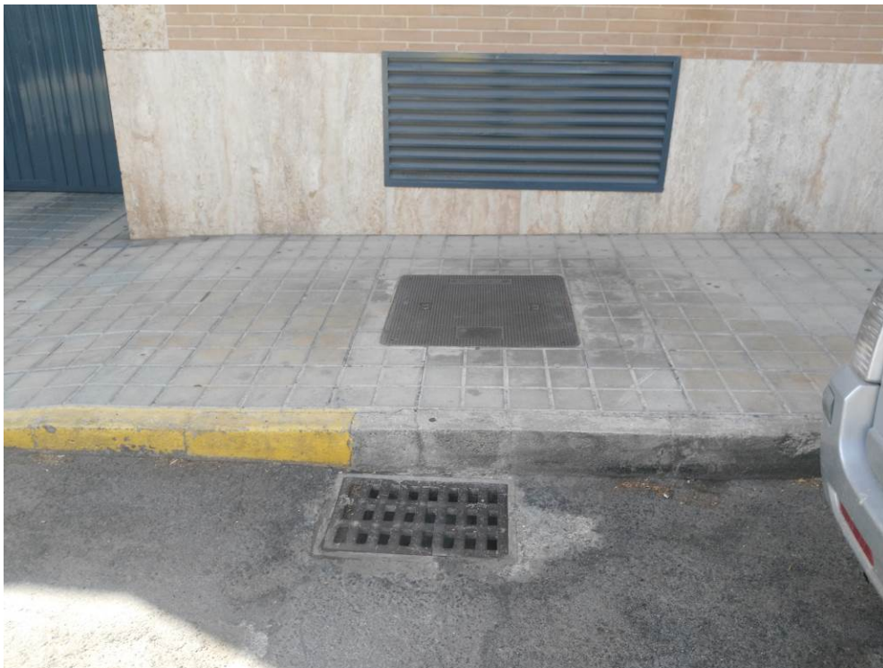
Ubicación del imbornal detectado junto al bordillo del acerado a la altura del inmueble número 3 de dicha calle.
