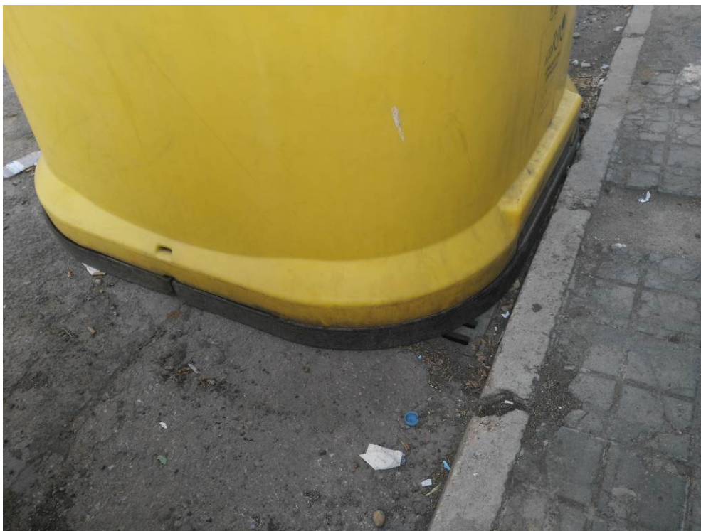
Ubicación de imbornal frente al anterior, tapado por contenedores.
