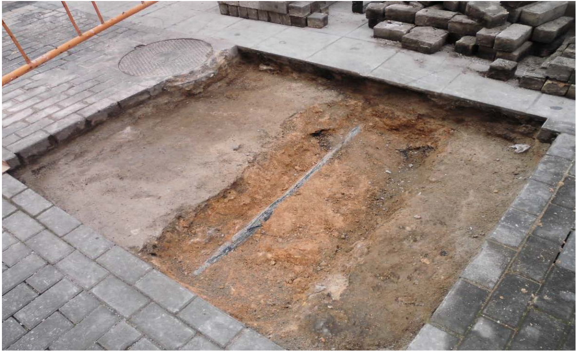
Solera de hormigón interrumpida con el paso de instalaciones.
