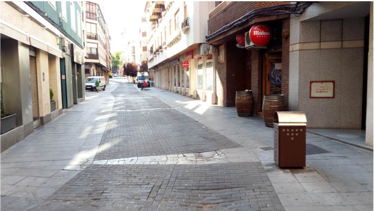
Hundimientos en calzada y acerado. Firme en mal estado, por paso de vehículos y autobuses urbanos.
