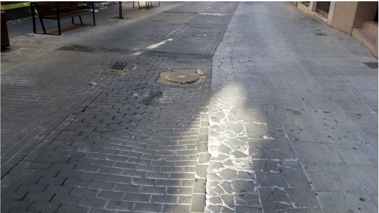
Hundimientos en calzada y acerado. Firme en mal estado, por paso de vehículos y autobuses urbanos.
