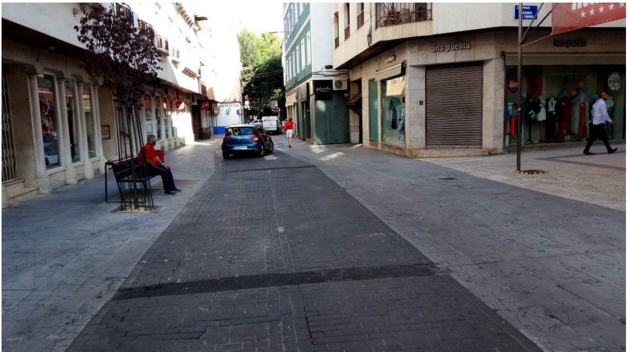
Pavimento de las aceras muy deteriorado. Apertura de zanjas transversales acabadas con distintos materiales.
