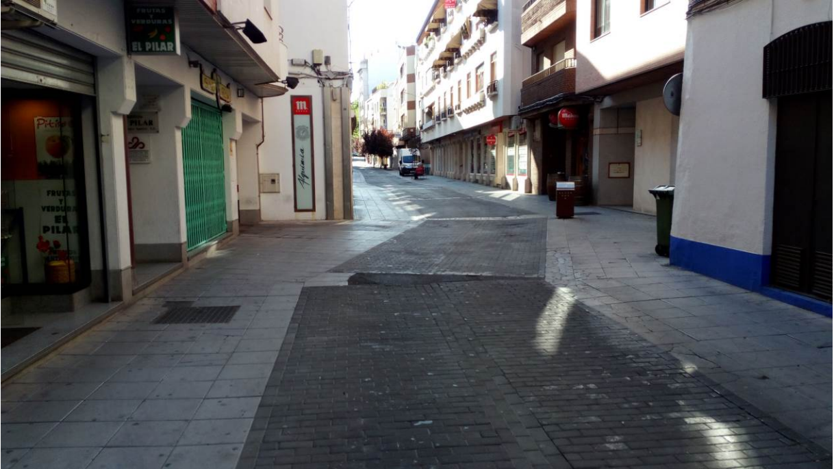
Adoquines y baldosas de acerado en mal estado. Deterioro por apertura de zanjas.
