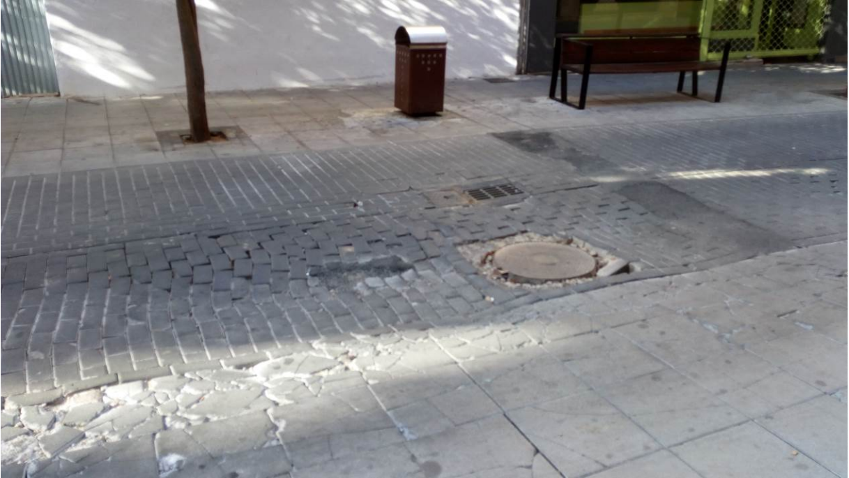
Hundimientos en calzada y acerado. Firme en mal estado, por paso de vehículos y autobuses urbanos.
