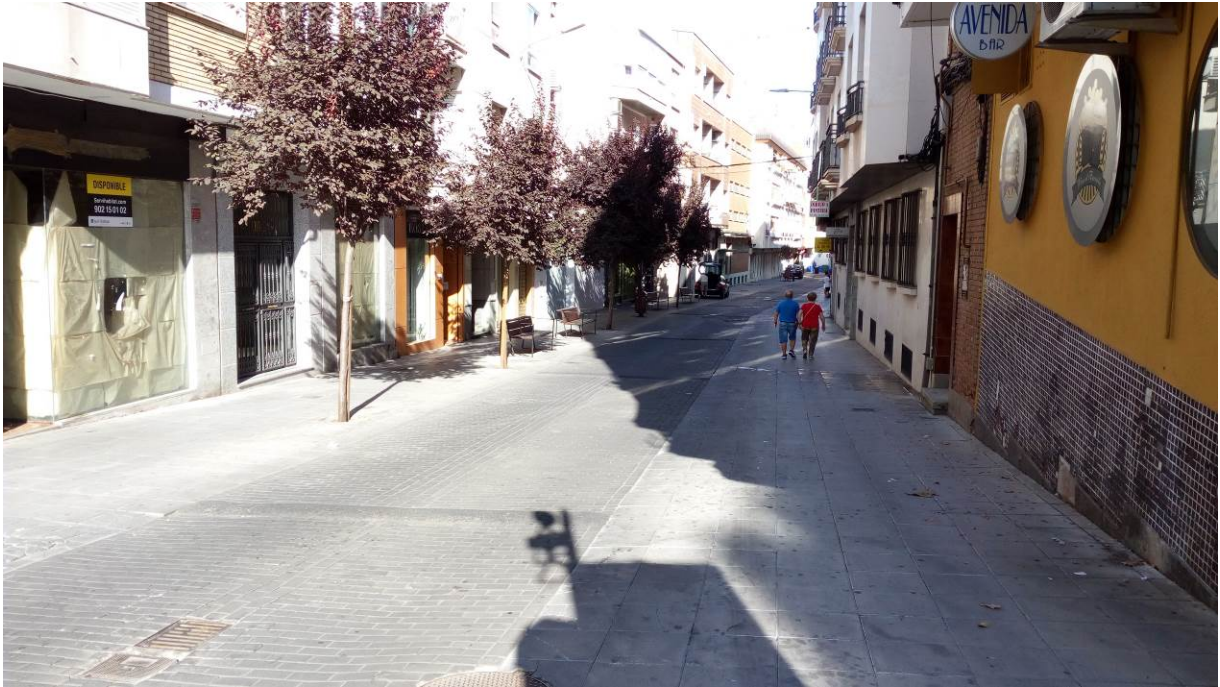
Diferentes acabados del pavimento de las aceras deteriorado.
