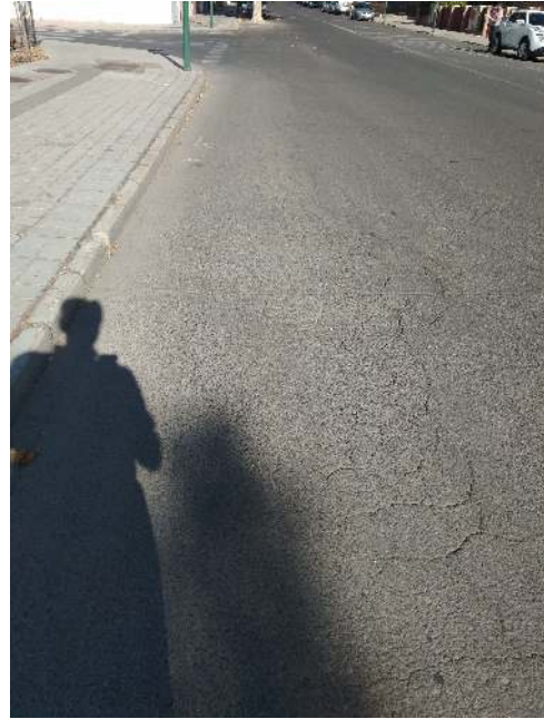
Foto 2.: Zona de agotamiento estructura. Piel de cocodrilo. C/Francia
