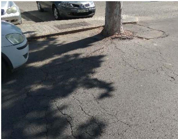
Foto 15.: Firme fisurado. A causa raíces de árboles.
