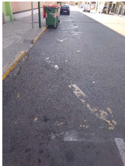
Foto 4.: Señalización horizontal carga y descarga.
