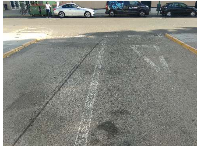
Foto 16.: Firme fisurado. Fondo de saco C/ Francia intercesión con C/ Suecia.
