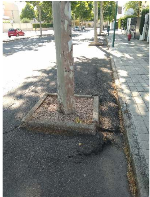
Foto 6.: Alcorque en mal estado, levando por raíces.
