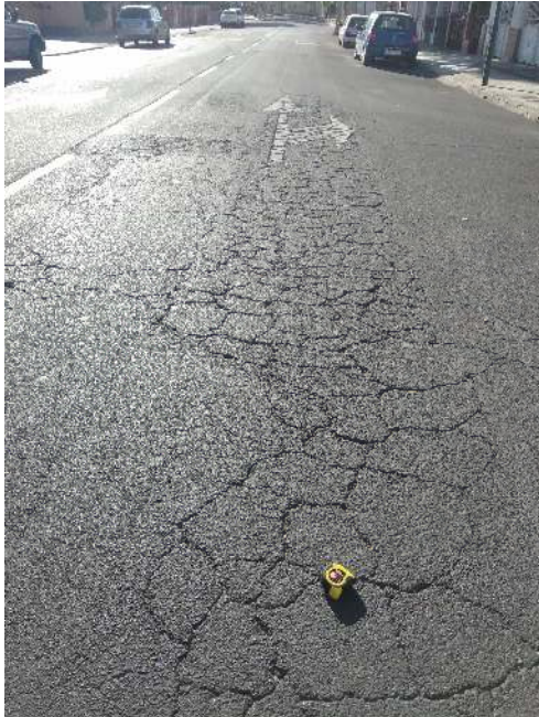
Foto 1.: Firme agotamiento estructura. Piel de cocodrilo. C/Francia
