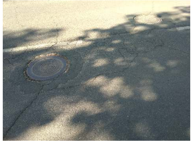
Foto 10.: Tapa en mal estado y entorno fisurado.
