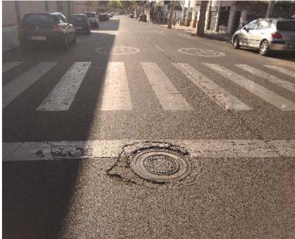
Foto 17.: Fisuración de la junta de trabajo y de los pozos existentes.
