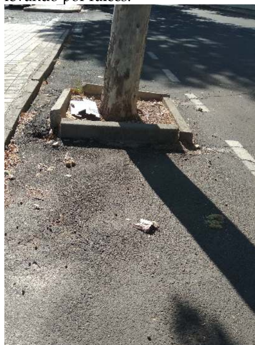
Foto 8.: Alcorque en mal estado, levando por raíces.
