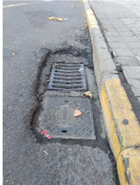
Foto 18.: Imbornal excesivamente hundido.
