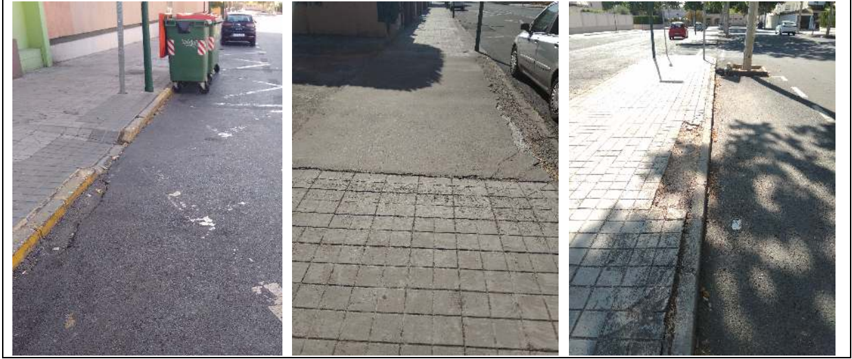
Fotos.: Zonas a reparar
