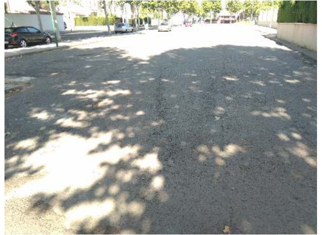
Foto 14.: Aparcamiento. Firme disgregado.
