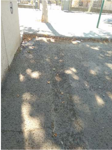
Foto 13.: Zona de aparcamiento. Imbornal obstruido.
