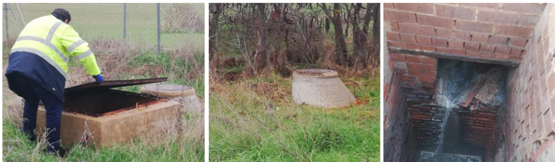
Imagen 3 Arqueta de resalto y pozo de registro a salida de emisario (izquierda), pozo de registro entrada (centro), arqueta de resalto (derecha).
